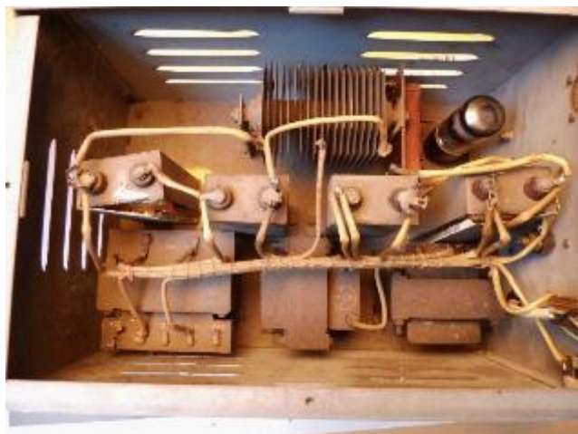
Interieur van de voeding, herkenbaar trafo, chokes en seleencel
